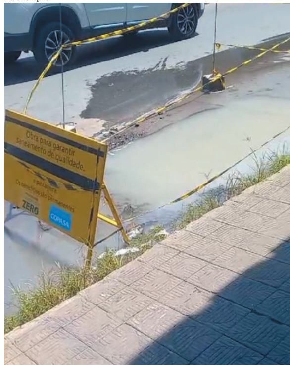
Vazamentos são comuns em Montes Claros
